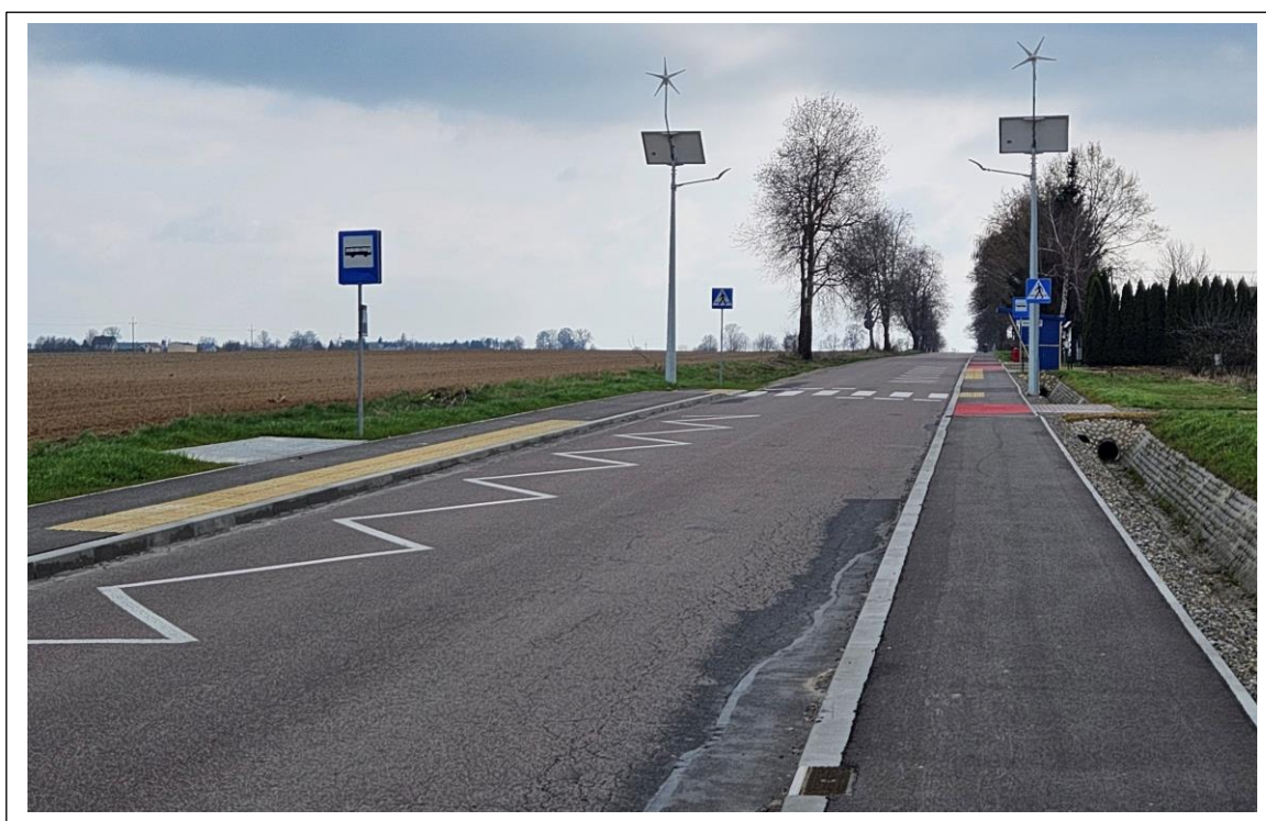
Fot. 19. Przebudowana droga powiatowa nr 2233L w zakresie w wykonania opaski bezpieczeństwa w miejscowościach Palikije Drugie i Stasin.
