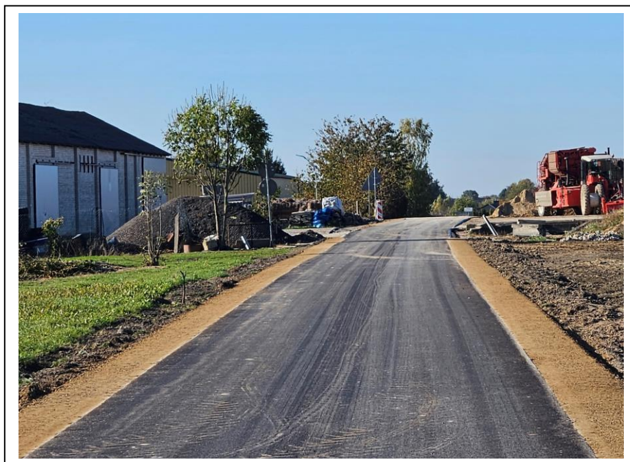
Fot. 20. „Przebudowa dróg gminnych na obszarze po PGRowskiem” – przebudowany został ciąg drogowy w miejscowościach Palikije Pierwsze i Palikije Drugie (drogi wewnętrzne) na odcinku od km 1+400,00 do km 2+787,71.
