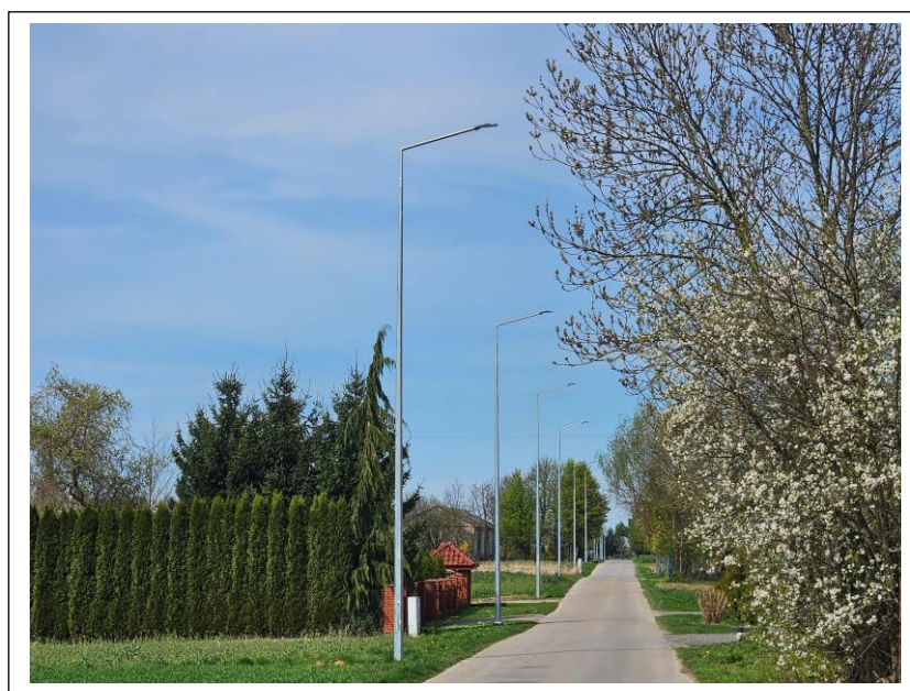
Fot. 27. Wybudowane oświetlenie w miejscowości Palikije Drugie przy drodze gminnej 106918L na odcinku 800 m.
